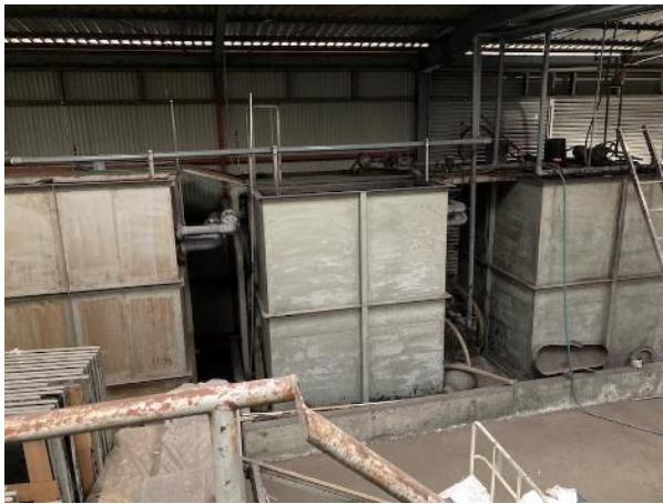
排水をさらに3つのタンクに溜めて浄化
