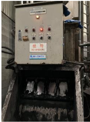
今治市内の藤田工業製の浄水機
