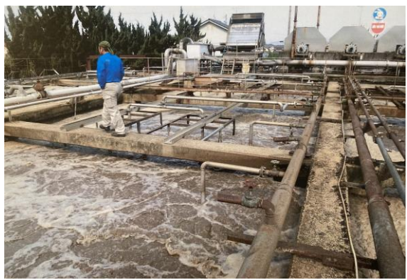
活性汚泥処理槽
