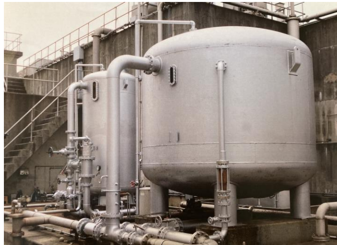
染色加工する前の水を綺麗にする作業もグリーンメンテナンスの仕事であり、手前が除濁濾過装置、うしろが軟水器（硬水を軟水にする装置）
